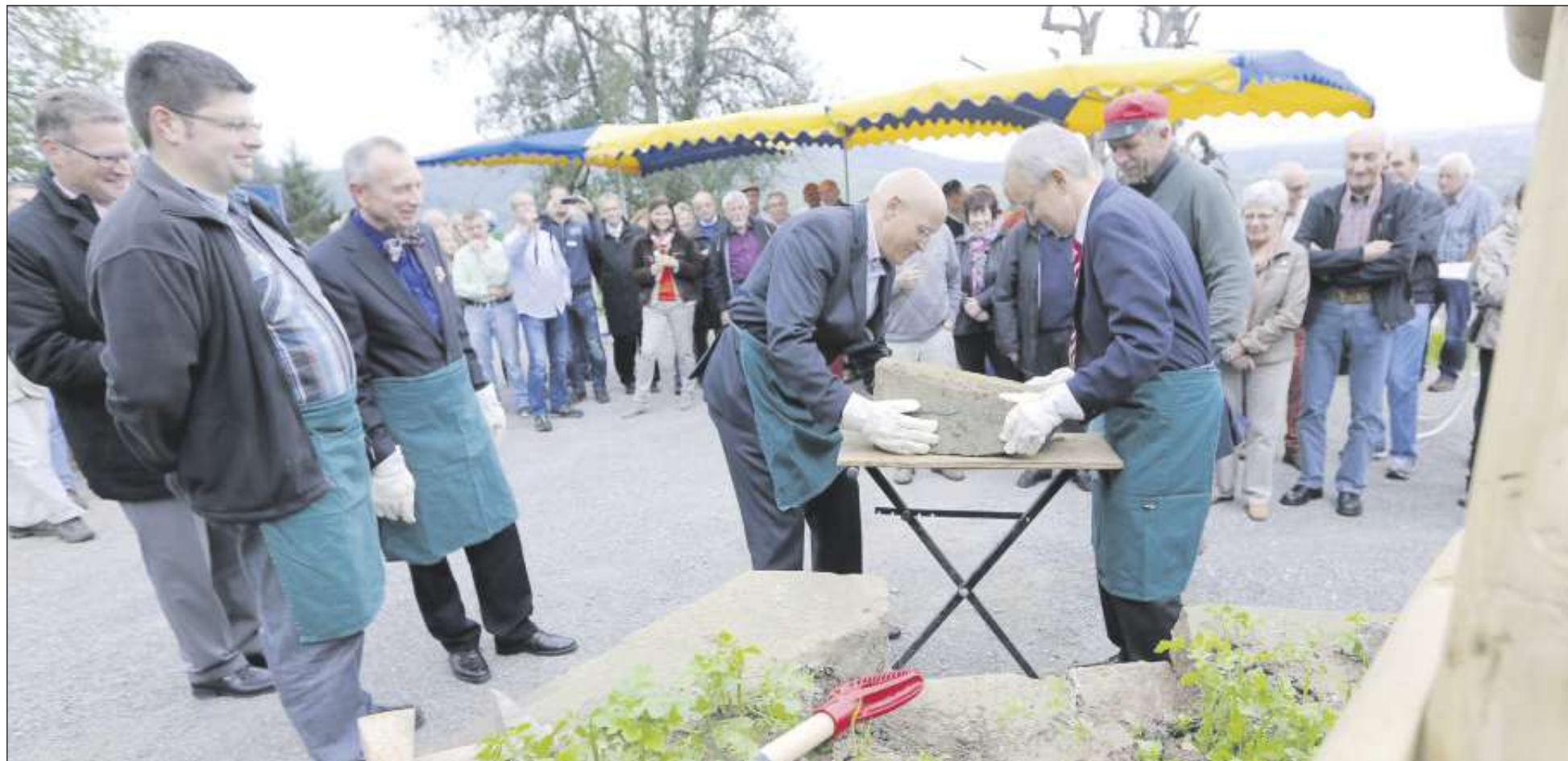
BM Stefan Altenberger (Mitte links) und Erster Landesbeamter Bernd Friedrich packen gemeinsam den letzten Naturstein an. Er sollte die letzte Lücke in der neuen Trockenmauer schließen.
