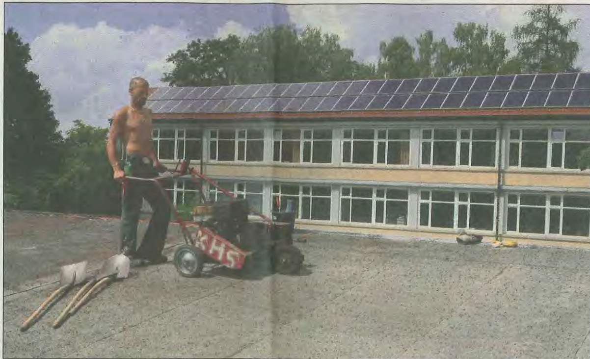
Der Haldenschulpa-villon – im Bild – bekam jetzt ein Solar-dach. Seit gestern gibt's Fotovoltaik-strom von der Sys-temhalle in Stetten. Archivbild: Habermann
